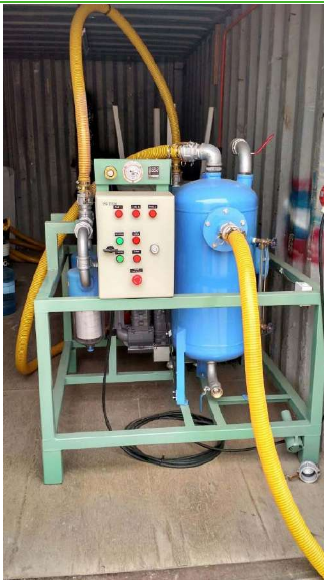
Imagen 7. Sistema de aireación de la biopila, compuesto por un soplador, filtros de partículas, filtros de carbón activado, tanque separador de humedad y tablero de control.
